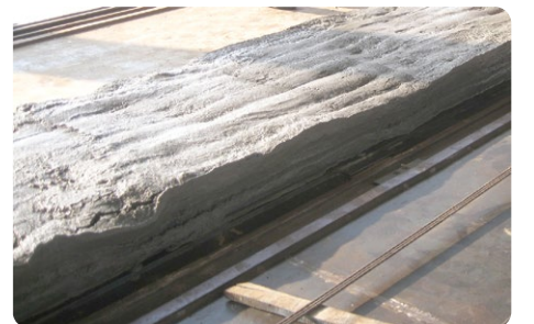
Şekil 2: Yanlış kıvam nedeniyle Boşluklu beton çökmesi örneği
